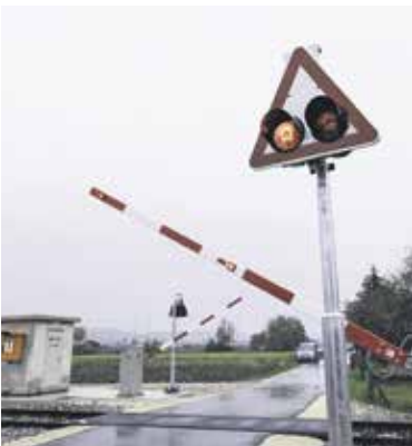
Nove železniške zapornice v Depali vasi
